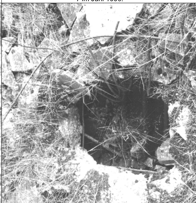
Fotografie 23: Eisenbetondecke des Leichenkeller 1 des Krematorium II von Birkenau. Öffnung Nr. 7 im Juli 1992.
