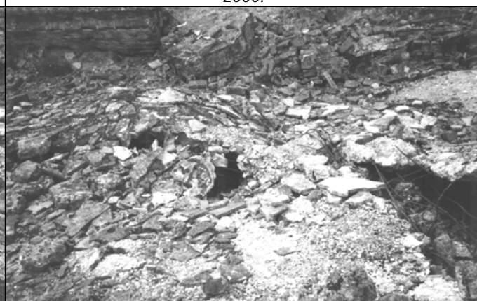
Fotografie 31: Eisenbetondecke des Leichenkeller 1 des Krematorium II von Birkenau. August 2000. Öffnung 8 (in der Mitte) und Fortsetzung des Risses, von dem sie einen Teil bildet.
