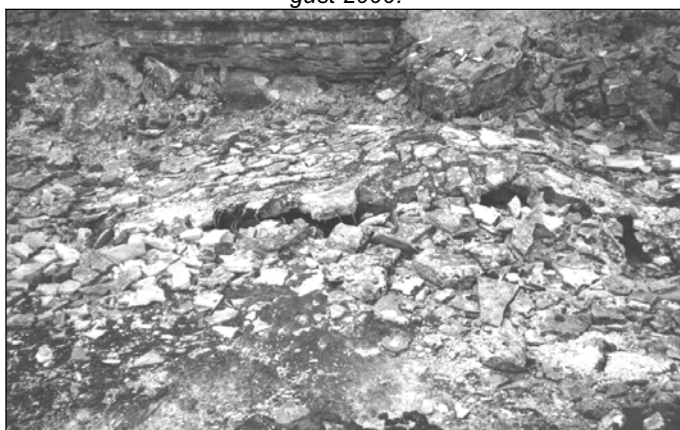
Fotografie 30: Eisenbetondecke des Leichenkeller 1 des Krematorium II von Birkenau. August 2000. Linie des Risses, zu dem Provans Öffnung Nr. 8 gehört – außen rechts auf der Fotografie, reicht über diese hinaus (siehe Fotografie 31).
