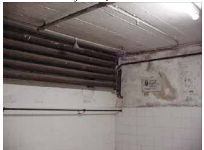
Heizungsrohre in der Gaskammer Mauthausen. Da Wärme nach oben steigt, werden Heizungsrohre immer unten angebracht. Diese Rohre können nur die Kühlrohre des ehemaligen russischen Kühlraums sein, denn Kälte sinkt nach unten. 19
